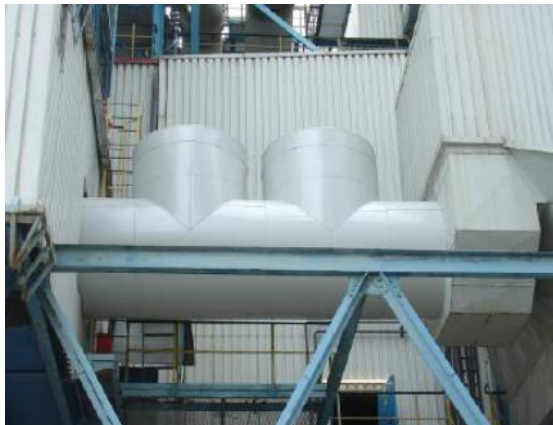
Abbildung 15: Abzweig zum Einbau eines Wärmetauschers
