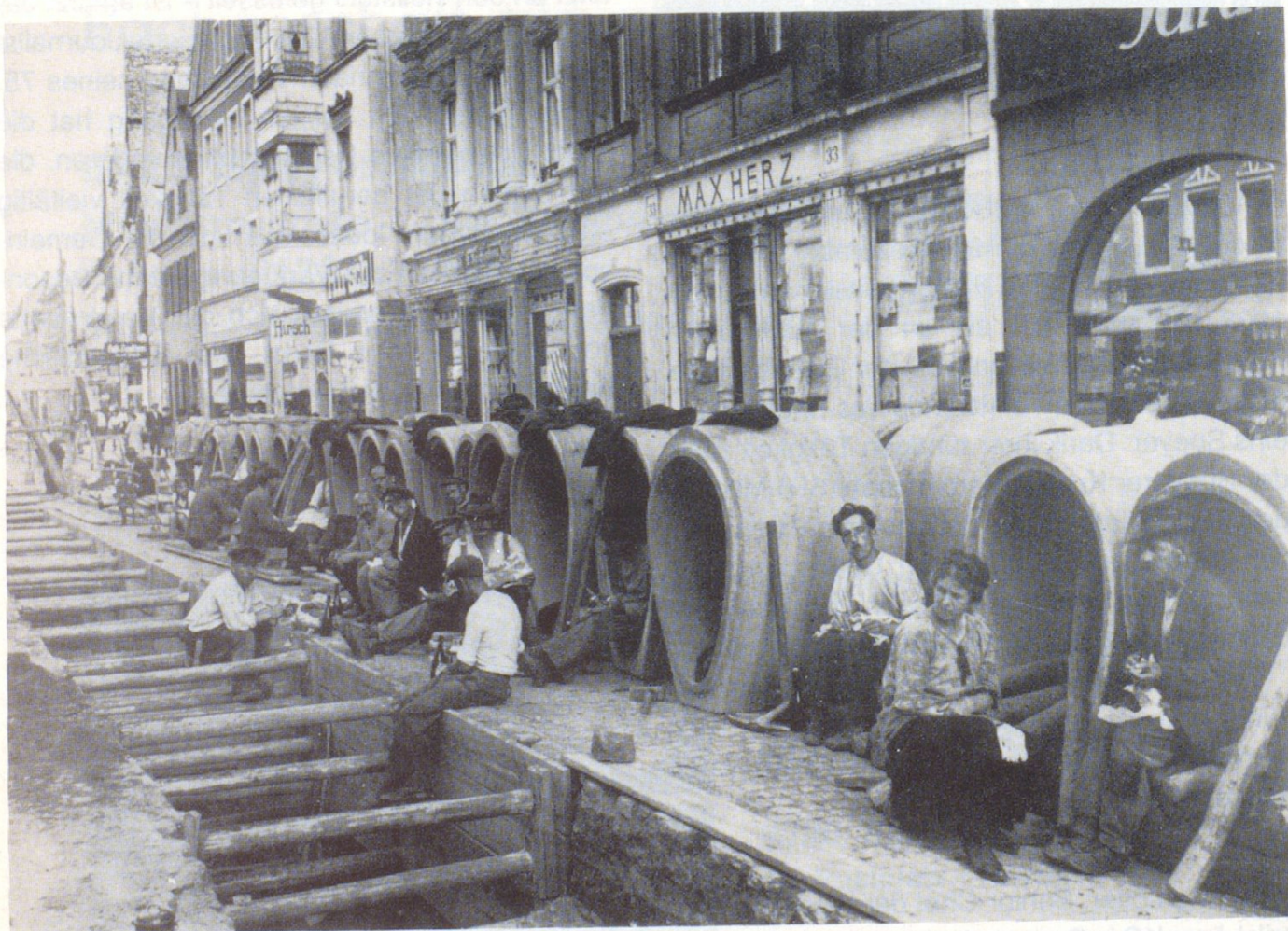
Als 1926 die Hauptstraße kanalisiert wurde, hatten viele Arbeiter schwere Arbeit zu verrichten. Die „Brotzeit“ wurde unmittelbar auf der Baustelle eingenommen.
