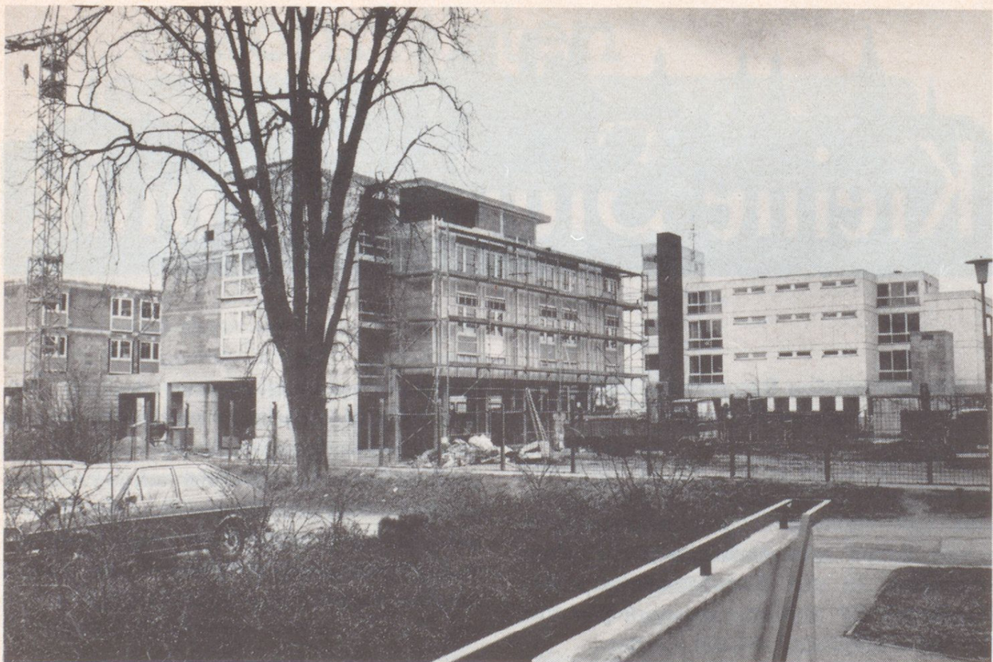
Im Rohbau fertiggestellt: Der Erweiterungstrakt für das Altenheim der Bürgerhospitalstiftung am Mausbergweg.
